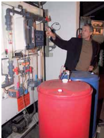
Roland Wirth vom Außendienst der Firma ProMinent – hier aufgenommen im Betrieb Völker – engagiert sich bei der Einführung des Chlordioxid-Systems in den Gartenbau. Im Vordergrund sind die getrennten Sicherheitswannen für Säure (rot) und Chlorit (blau) zu sehen
